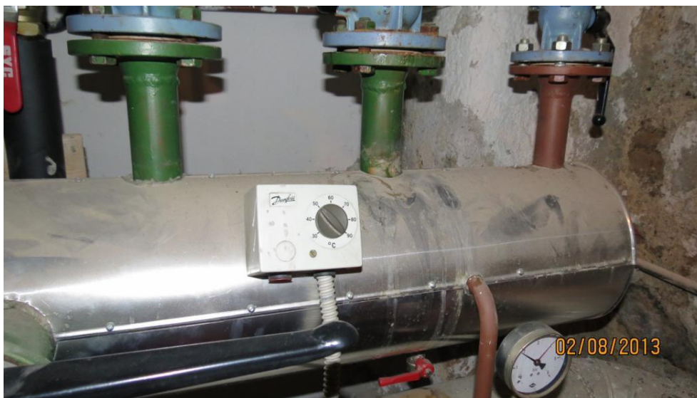
Slika 4.4: Termostat za regulacijo temperature v celotni stavbi
