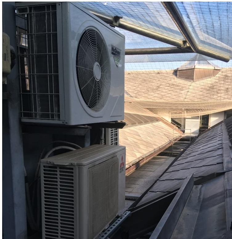
Slika 4.6: Primer zunanjih enot split klimatskih naprav
