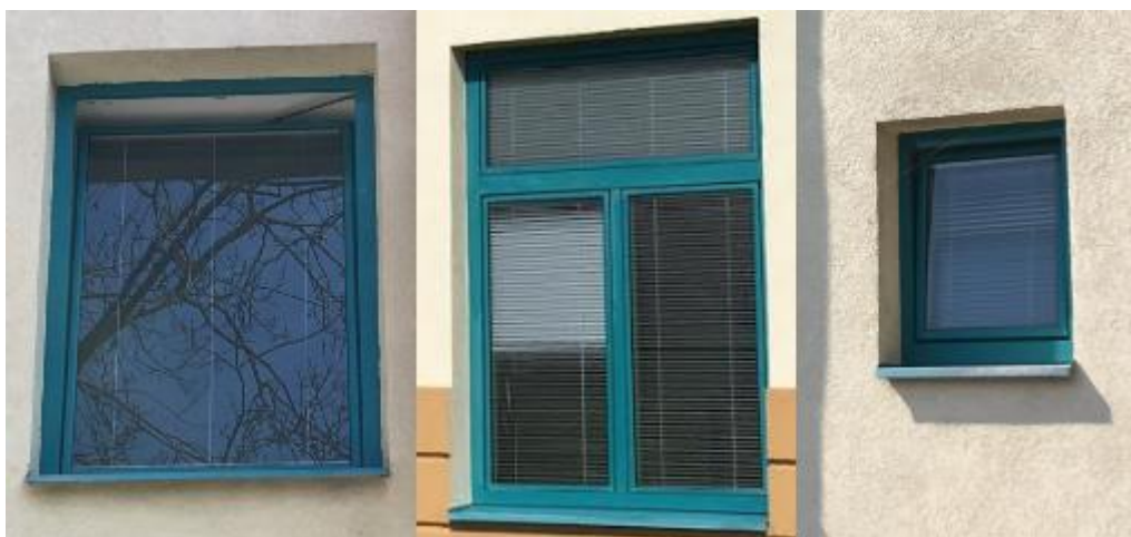
Slika 5.3: Prikaz tipov PVC oken, vgrajenih v stavbo
